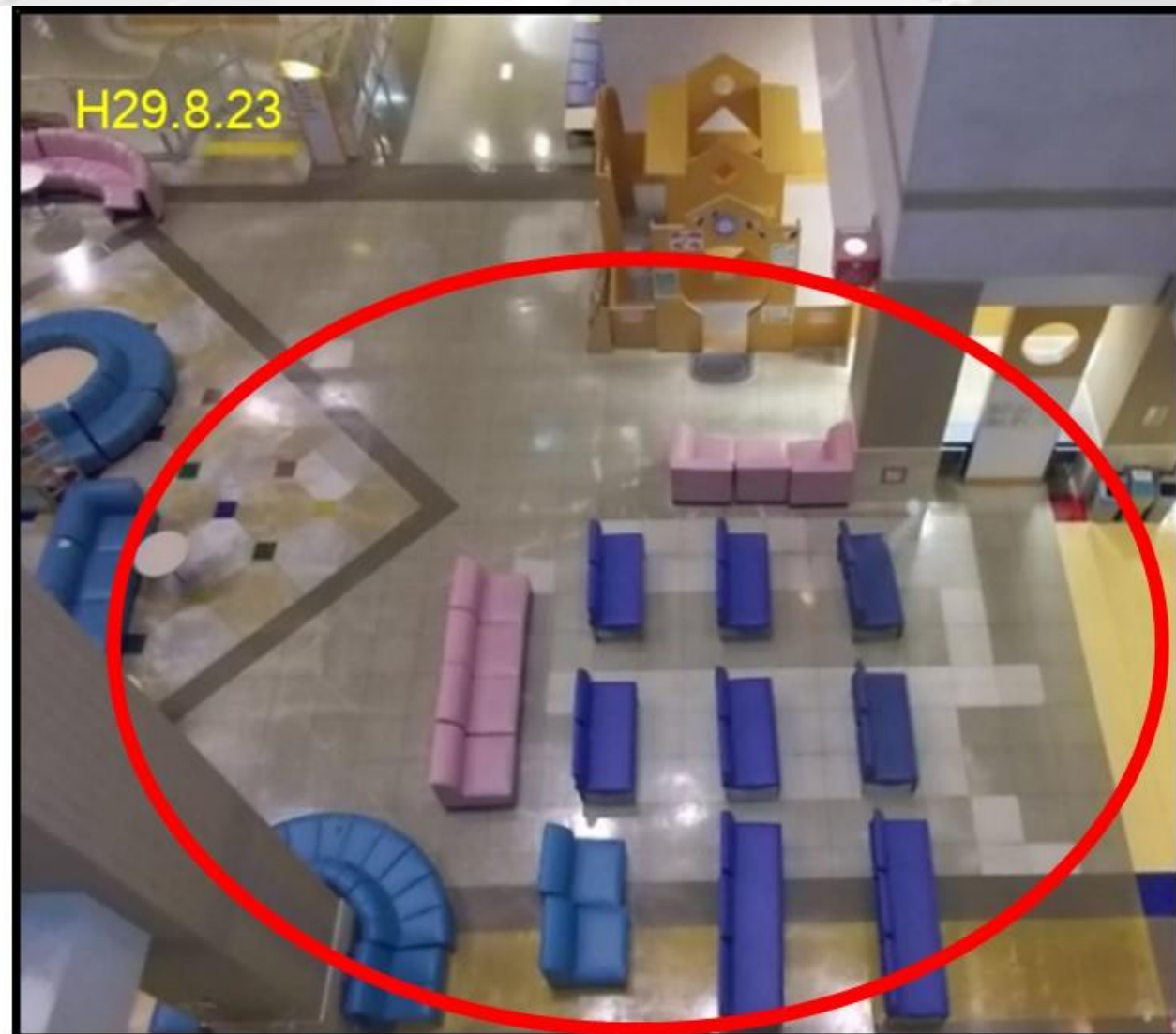
全体的に黒ずみ修繕工事前も部分的に張り替えられていた
