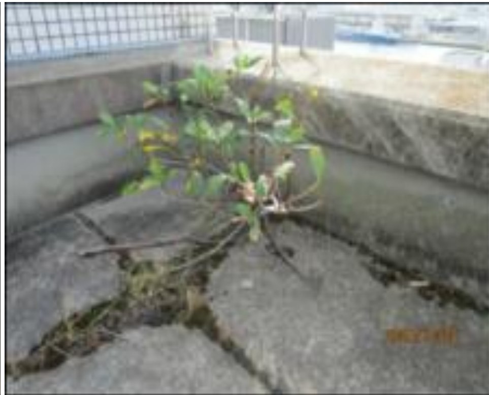
伸縮目地に繁茂 した植物
