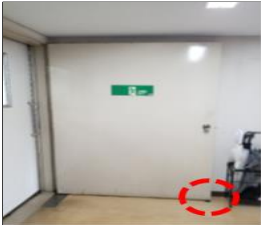
常時解放された防火扉
