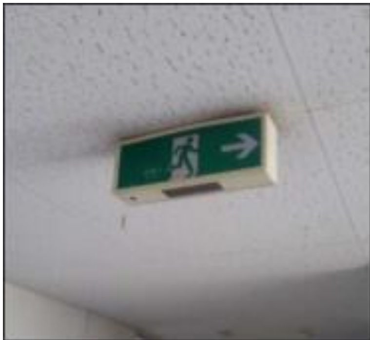
点灯しない誘導灯
