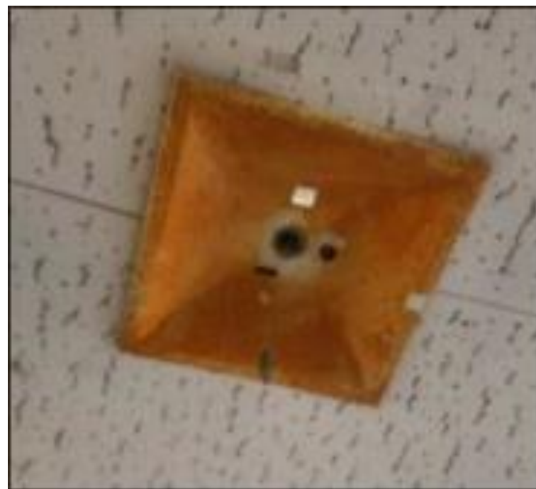
ランプが外された 非常用照明器具
