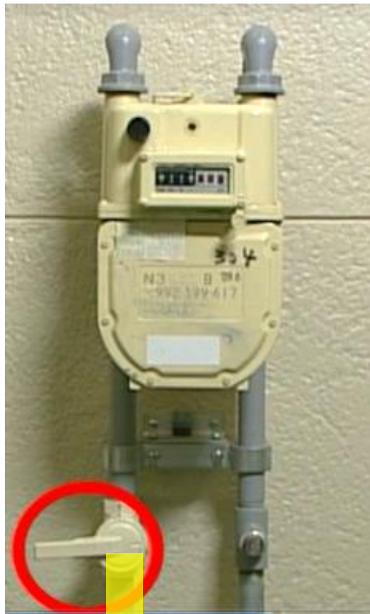
メーター閉栓状態
