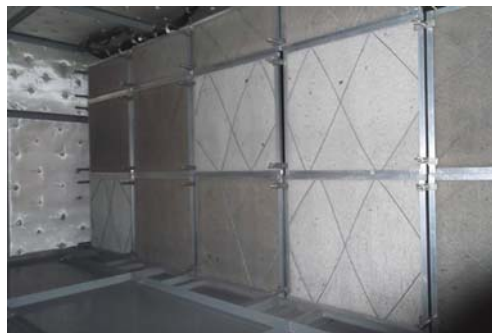
空調機内部のフィルター
