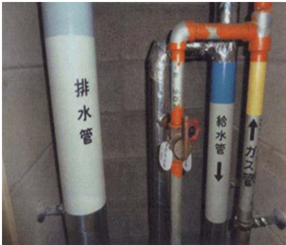
パイプシャフト 内の配管類
