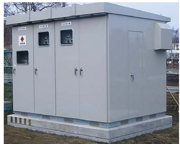
屋外受変電設備
