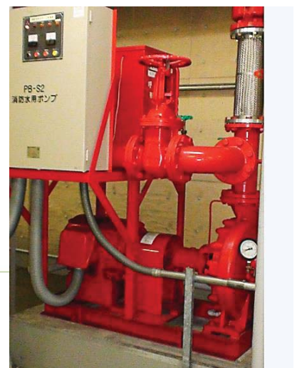
消火栓ポンプ
