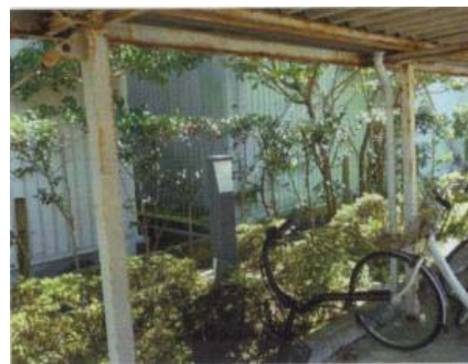
外回りの屋根の錆
