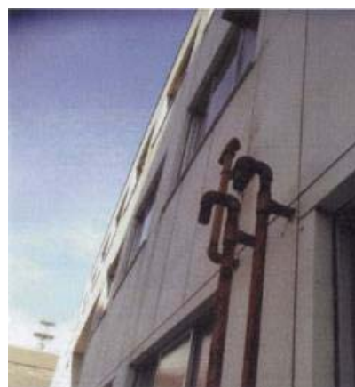
壁面に設置の配管錆の発生
