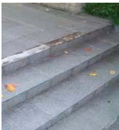
外回り階段タイルの剥がれ
