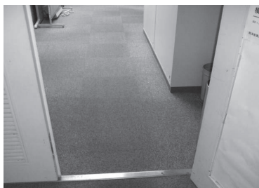
(写真1) カーペット床の重歩行部分が黒ずんでおり、歩行しない部分との差がはっきりしている。
