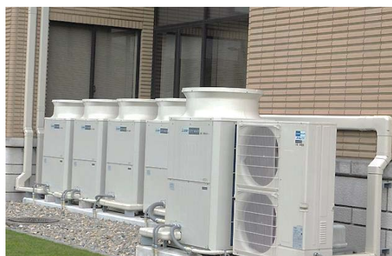
個別空調用室外機
