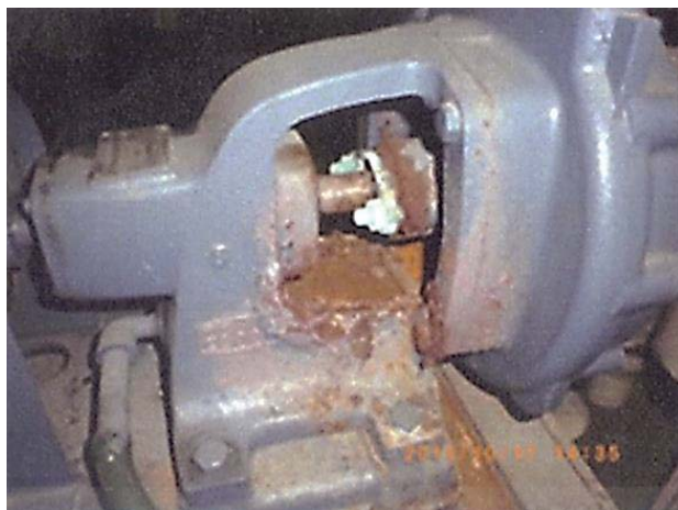
空調用ポンプ
