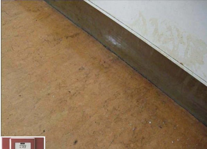
幅木と壁面の汚水よごれ
