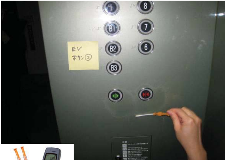
エレベータかご内操作盤の手あか
