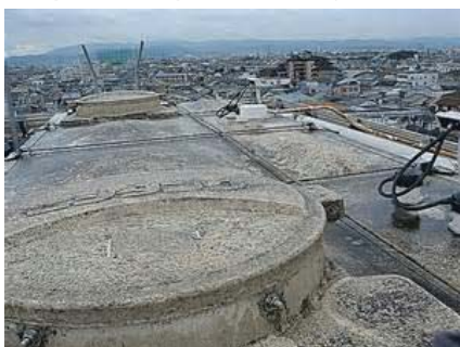
高置水槽:FRPの劣化
