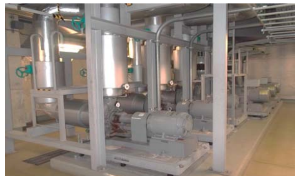
冷温水ポンプ
