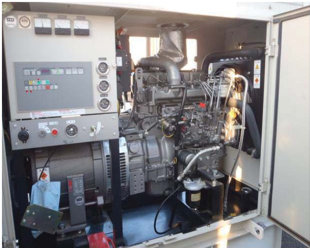
非常用発電設備
