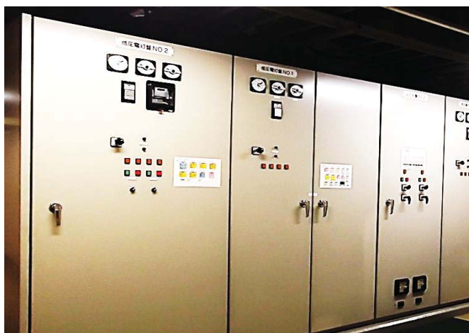
屋内受変電設備
