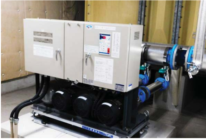
加圧給水ポンプ
