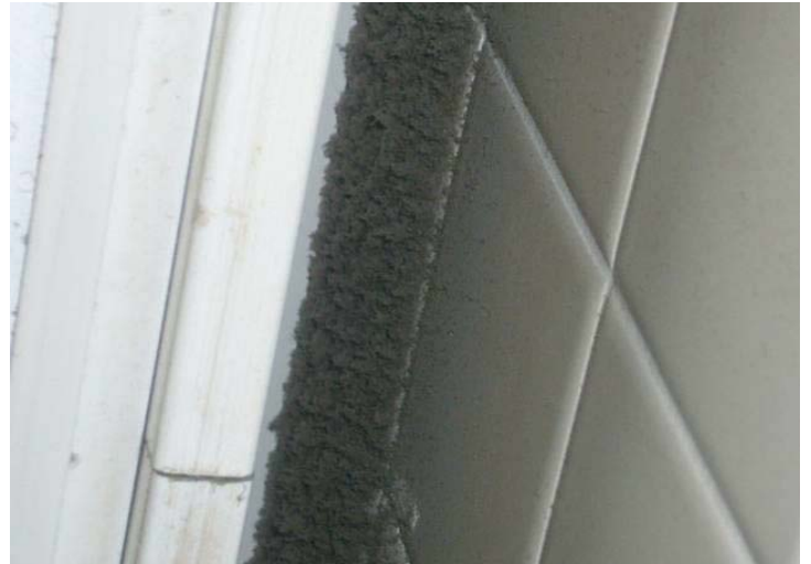
トイレブース内天井換気口のほこり
