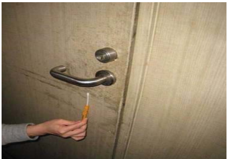
共用出入口扉取手廻りの汚れと手あか
