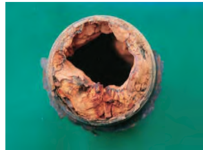
【給水管内の赤さび】
